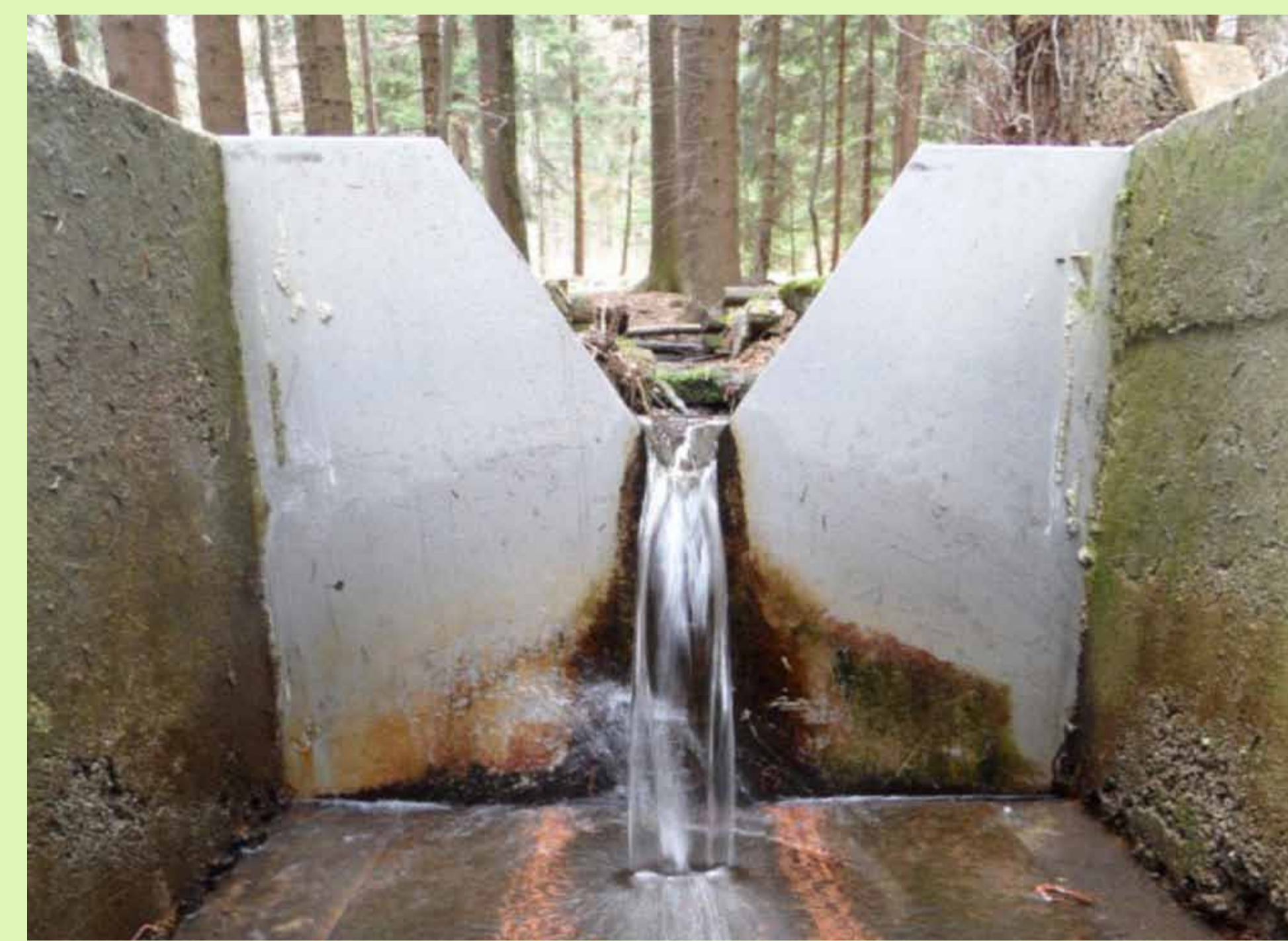
Obr. 3 Trojúhelníkový přeliv – ocelová konstrukce v betonovém žlabu – v provozu cca 1 rok.
