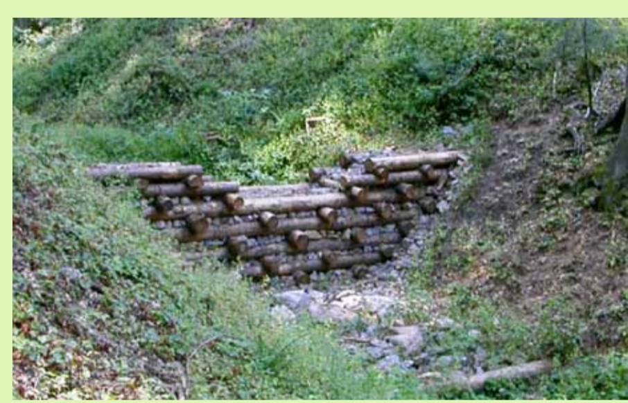
Obr. 5b Srubová přehrážka
