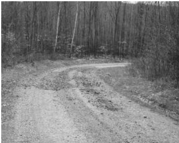
Obr. 1 Poničený kryt z penetrační makadamu
